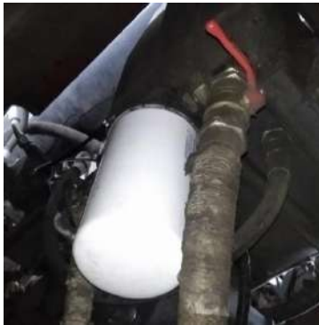
Рисунок 3.8 – Перекрытый кран сливного фильтроэлемента
