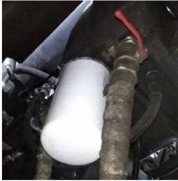
Рисунок 3.12 – Перекрытый кран сливного фильтроэлемента
