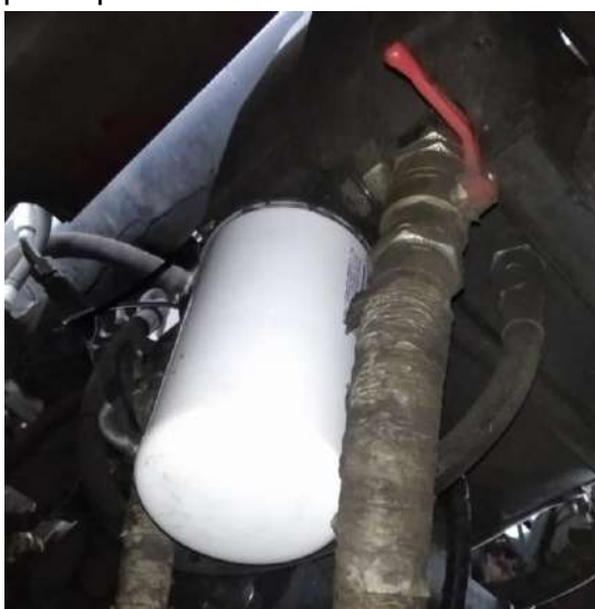
Рисунок 3.10 – Вид на перекрытый кран сливного фильтроэлемента
