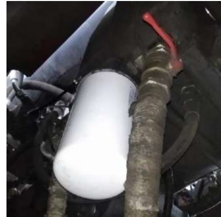
Рисунок 3.8 – Перекрытый кран сливного фильтроэлемента
