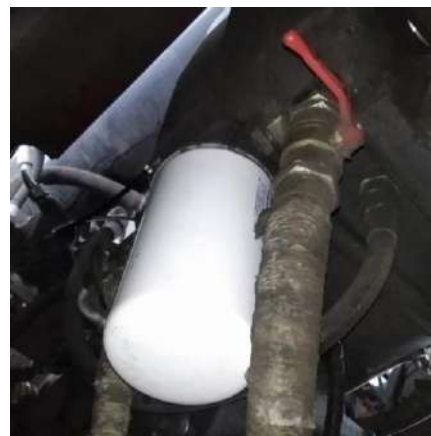
Рисунок 3.8 – Перекрытый кран сливного фильтроэлемента
