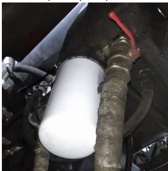
Рисунок 3.13 – Вид на перекрытый кран сливного фильтроэлемента
