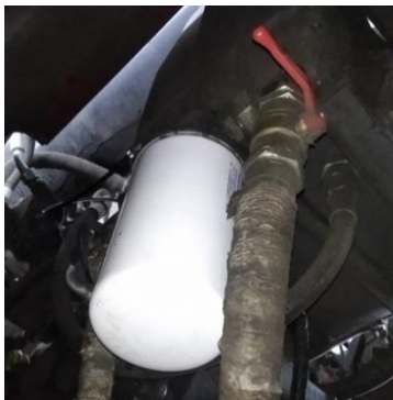
Рисунок 3.12 – Перекрытый кран фильтроэлемента сливного фильтра
